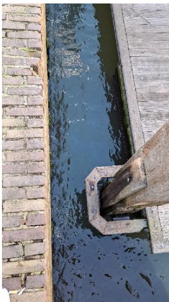
Figuur 28: Ruimte tussen een kademuur en steiger in de binnenstad van Dordrecht.
