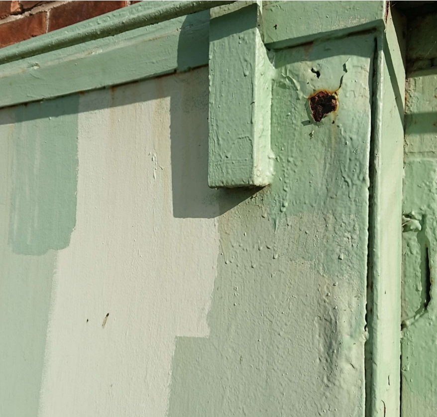
Boven, stalen schuifdeur westgevel ter hoogte as 5. Bovendeel buiten opgeroest
