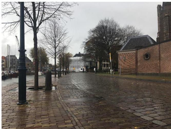
Foto 2.2 Voorbeeld verzakking straatwerk (bij boombunker 9)
