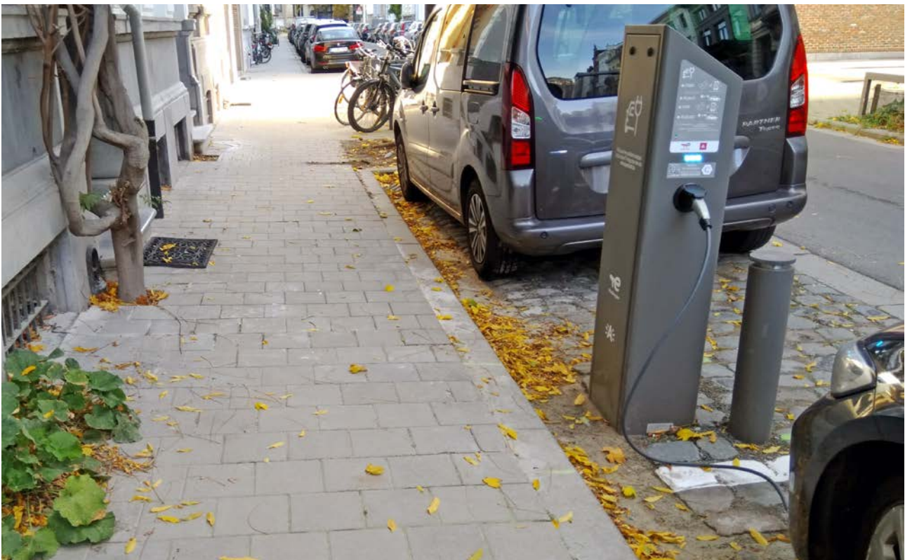
Figuur 12. Laadpaal tussen twee parkeervakken en dus niet op het trottoir (Foto Voetgangsbeweging vzw, Vlaanderen)
