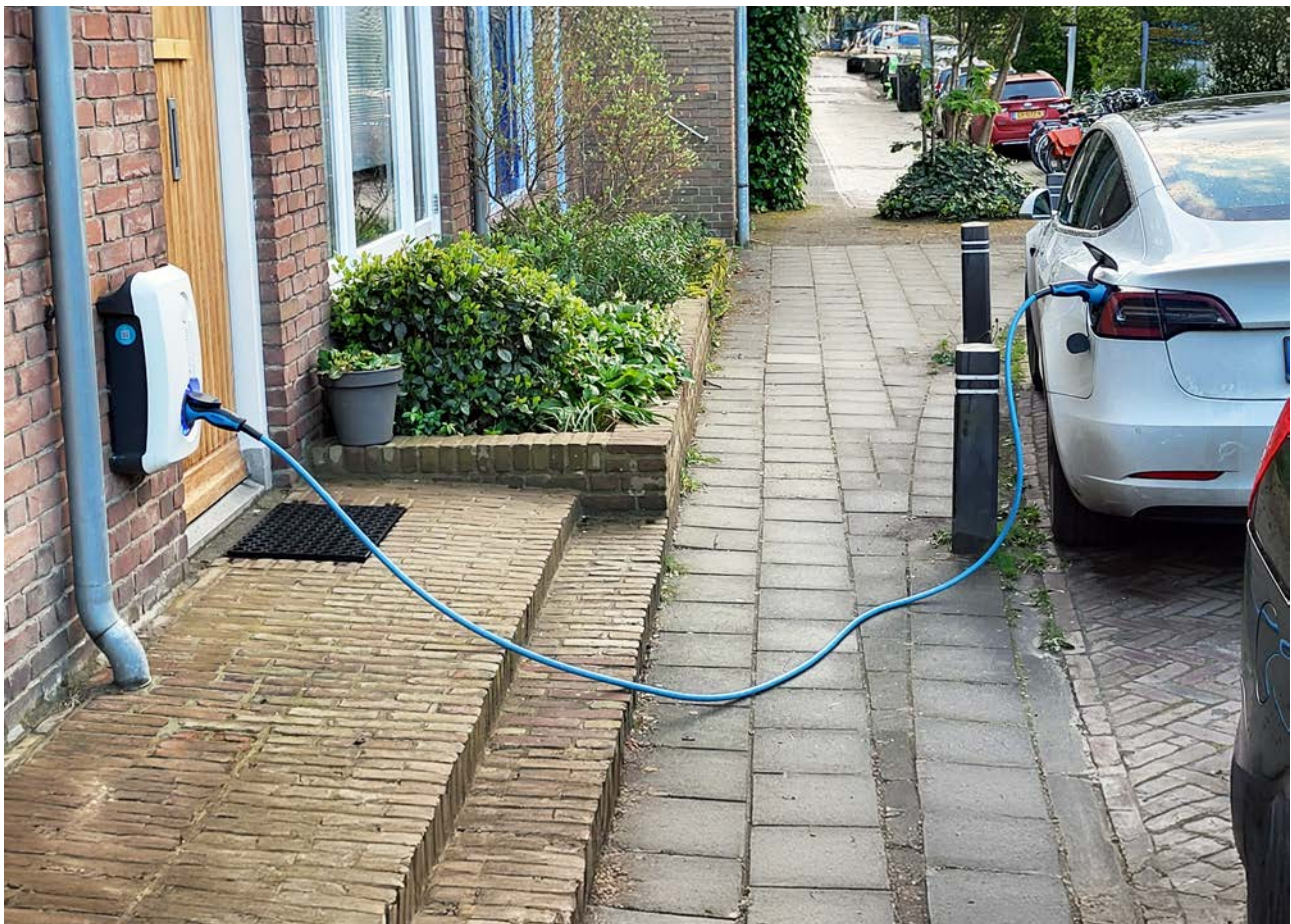
Figuur 2. Losse kabel is niet voor iedereen passeerbaar en levert struikelgevaar op
