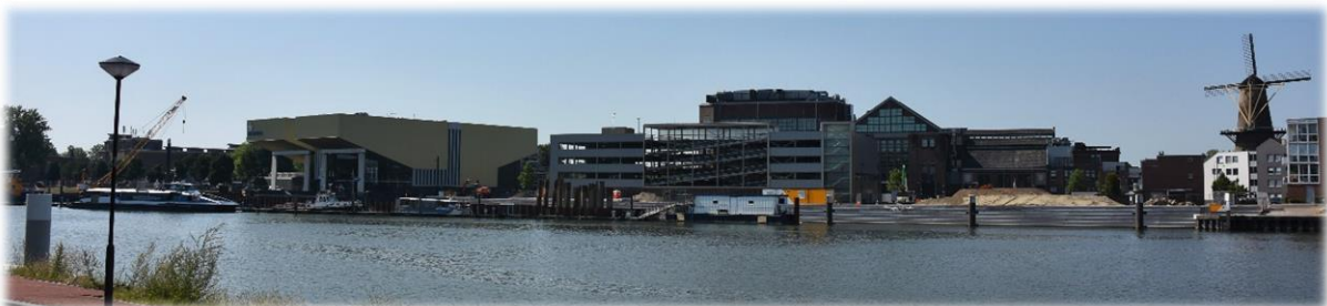
Energieterrein: Recent aangelegde betonnen trappen en metalen oeverwanden. Links op de foto het plaatsen van metalen oeverwanden.
