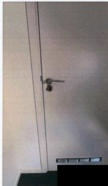
Foto 21: geforceerd slot toegangsdeur archieftruimte
