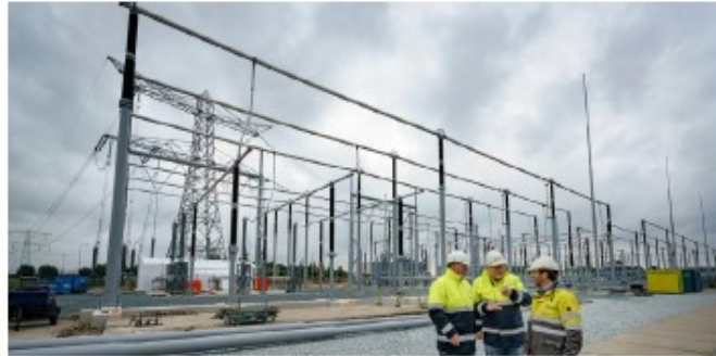
EHS-HS station (van 220-380 naar 110-150 kV)
