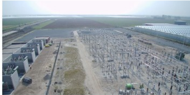
HS-MS station (van 110-150 naar 3-23 kV)
