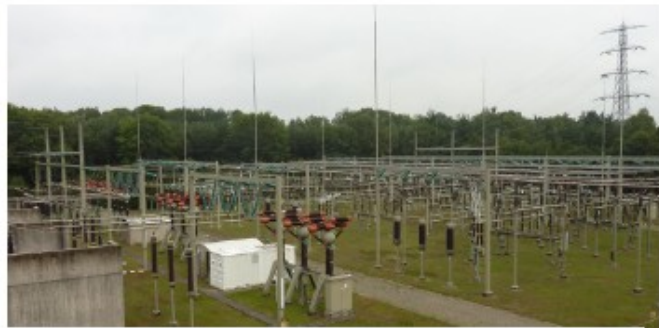
HS-TS station (van 110-150 naar 25-66 kV)
