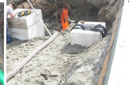
Wortels veroorzaken schade aan kabels Baanhoekweg
